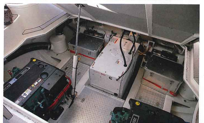
Bestens zugänglicher Maschinenraum mit blitzsauber installierter Technik. Die Volvo-D6-Diesel generieren jeweils 320 kW (435 PS)
